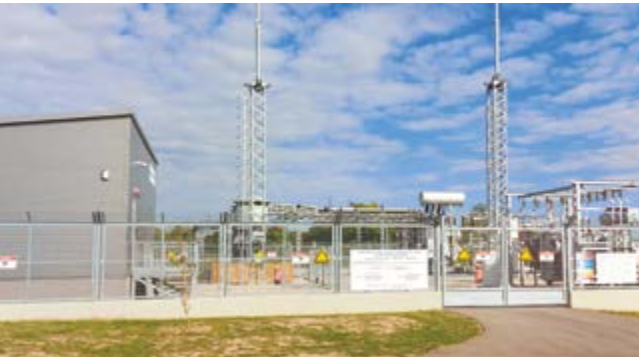
Újonnan épített alállomás Fotó: MVM Balance Zrt.
