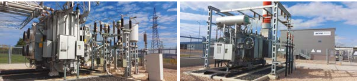
100 MVA, 132 / 10,5 kV és 16 MVA, 10,5 / 6,3 kV transzformátorok Fotó: MVM Balance Zrt.
