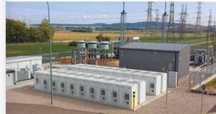
Előtérben a Hórusz főberendezései, PCSU és az akkumulátorszekrények, háttérben az újonnan épített aláállomás Fotó: MVM Balance Zrt.
